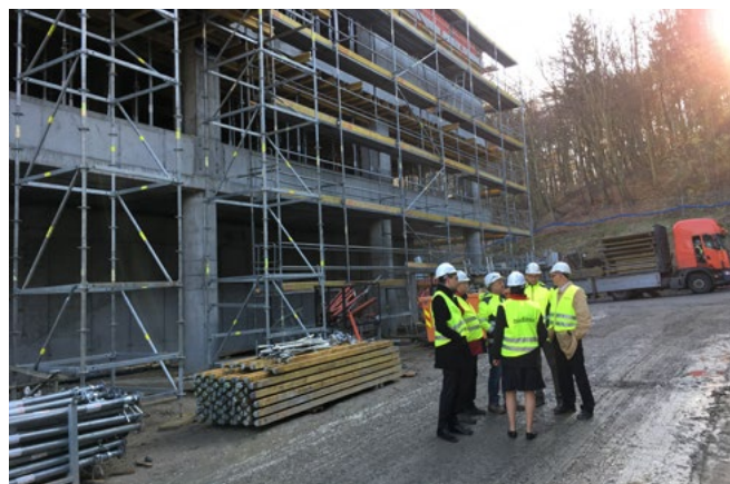
Okresowa wizytacja przez inwestora placu budowy i postępów w realizacji kolejnych podetapów budowy. Po lewej stronie coraz wyższy budynek radioterapii i onkologii oraz medycyny nuklearnej
