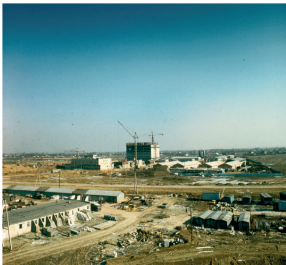
Rycina 29. Budowa nowej siedziby Instytutu Onkologii na Ursynowie, koniec lat 70. (ze zbiorów Redakcji Naukowej NIO-PIB)
