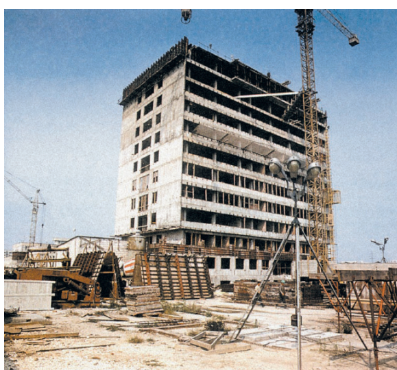
Rycina 30. Budowa nowej siedziby Instytutu Onkologii na Ursynowie – powstaje budynek naukowy (ze zbiorów Redakcji Naukowej NIO-PIB)
